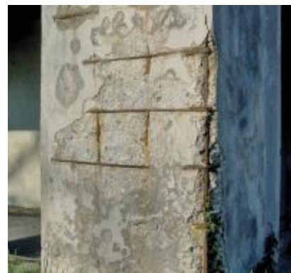
Phénomène de corrosion d'un pilier en béton
